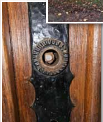
Schwer zu reparieren: Abgebrochener Türgriff in der Ehrenhalle
